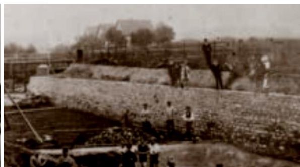
1914: Das Bad an der Westerfeldstraße befindet sich im Bau. 1945 kommen 100.000 Badegäste Foto: Sammlung Wibbing
