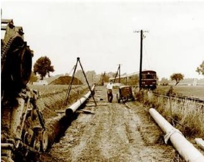
Erweiterung: Das Gasleitungsnetz wurde im Laufe der Jahre stets ausgebaut. Hier erfolgt die Verlegung der Rohre entlang der Bahnstrecke Richtung Hillegossen im Jahre 1967. FOTOS: ARCHIV STADTWERKE BIELEFELD
